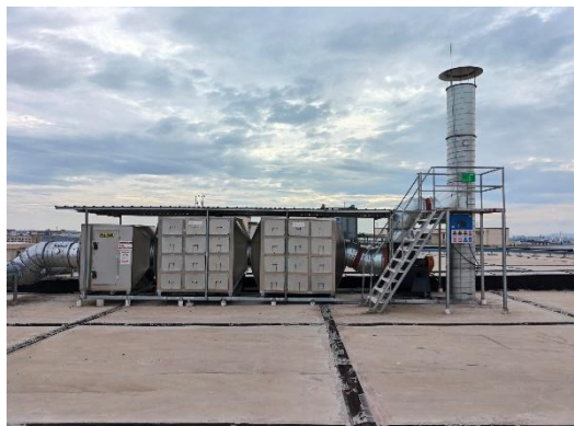
排气筒 DA001 处理措施 (过滤棉+布袋除尘+二级活性炭)
