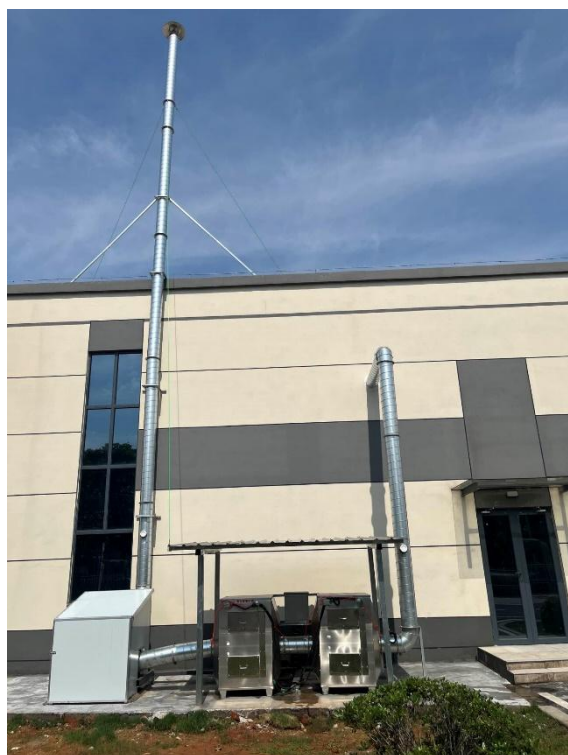
排气筒 DA002 处理措施 (二级活性炭)
